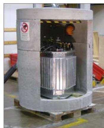
Trafo installeret i betonrør
