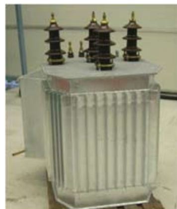
Trafo med reaktor
