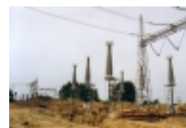
400 kV endemuffer med silikoneskærme.
